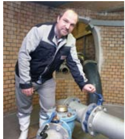
Regelmäßige Wartung ist Voraussetzung für die störungsfreie Wasserversorgung
